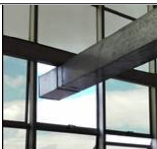
FOTOGRAFÍA 5. DUCTO DE DESCARGA
