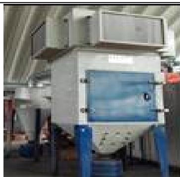
FOTOGRAFÍA 4. FILTRO ANTERIOR AL CICLON EQUIPO DE CONTROL
