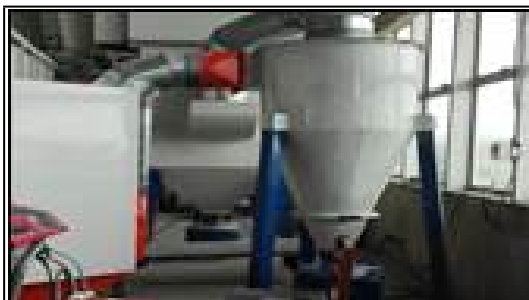
FOTOGRAFÍA 3. EQUIPO DE CONTROL (CICLON)
